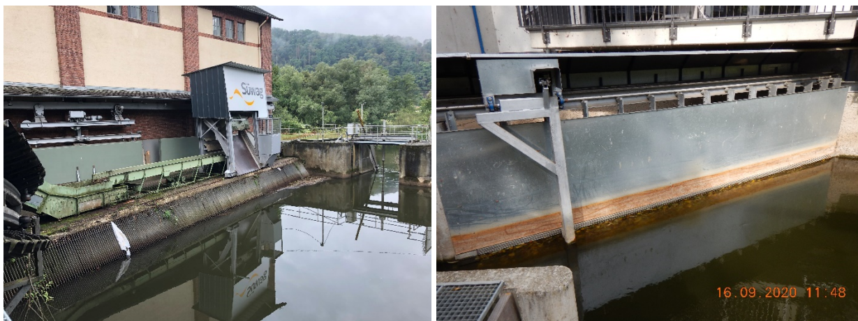
Abb. 3: Vertikalstabrechen und seitlicher Leerschuss (links) und Horizontalfeinrechen (rechts) im Einlaufbereich von WKA an der Lahn (Fotos: CDM Smith)
