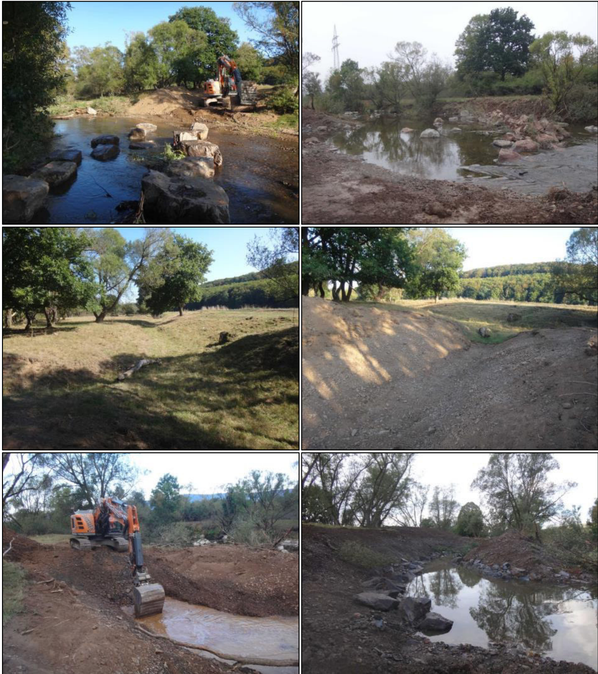
Abb. 25: Strukturierungsmaßnahmen Sterzhausen (3). Oben links: Bau einer Bühne. Oben rechts: Fertige Bühne. Mitte links: Furkationsrinne vor Anschluss an Hauptfluss. Mitte rechts: Anschluss Furkationsrinne. Unten links: Vertiefung des Winterquartiers. Unten rechts: Fertiges Winterquartier.
