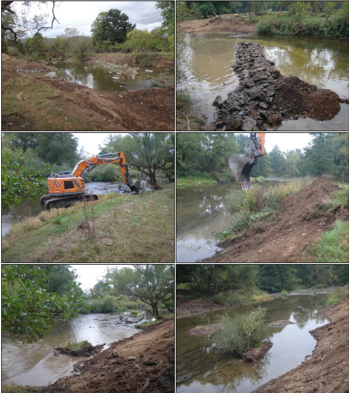
Abb. 26: Strukturierungsmaßnahmen Sterzhausen (4). Oben links: Fertige Buhne mit Winterquartier. Oben rechts: Eingebaute Weide als Strömunglenker. Mitte: Ufer vor Abflachung. Unten: Abgeflachtes Ufer.
