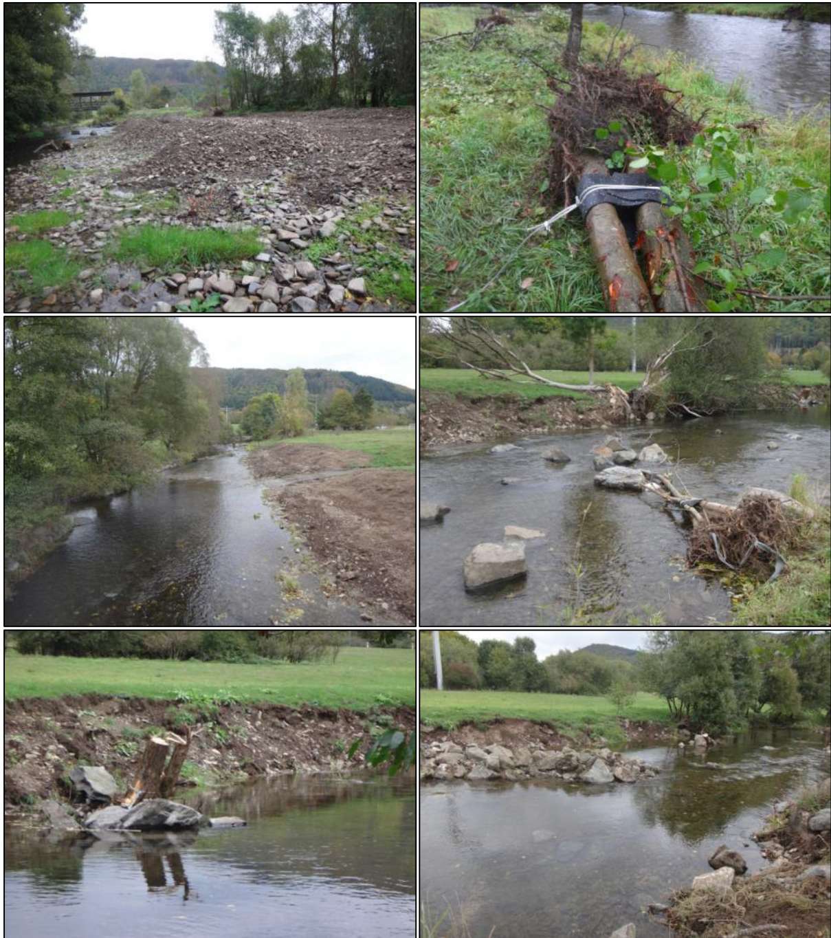
Abb. 17: Strukturierungsmaßnahmen Wallau (2). Oben links: Kiesdepots entlang des Hauptverlaufs. Oben rechts: Baumschutz an Befestigungsseil. Mitte links: Abgezogene und abgeflachte Berme unterhalb Holzsteg. Mitte rechts: Eingebaute Steine aus Uferbefestigung und Baum mit Ankersteinen. Unten links: Eingebauter Wurzelteller. Unten rechts: Buhne als Strömunglenker in unterem Nebengerinne.
